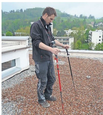
Elektronische Leckortung auf dem Flachdach.
